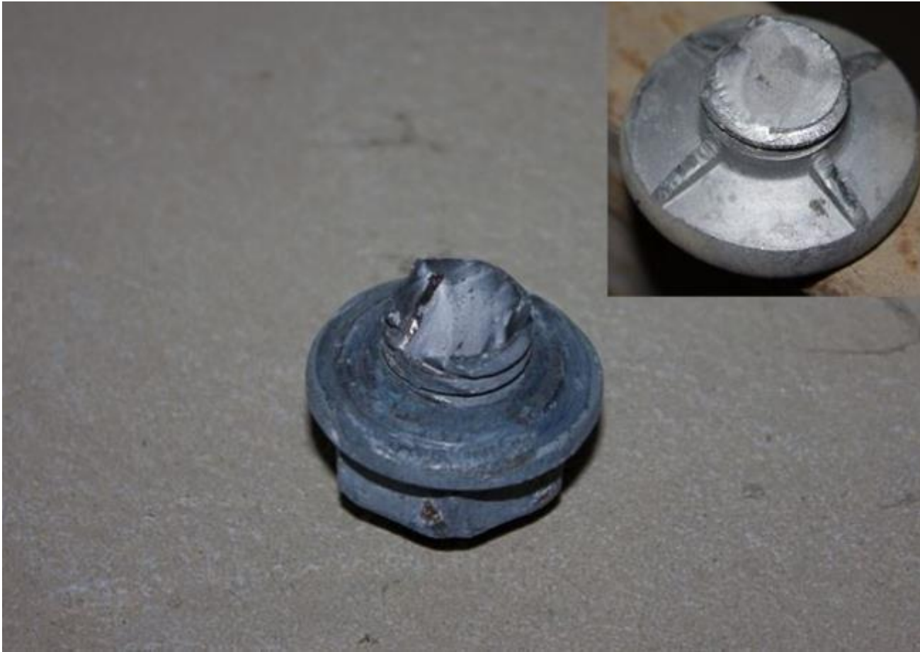
Головка болта оторвана от стержня.
