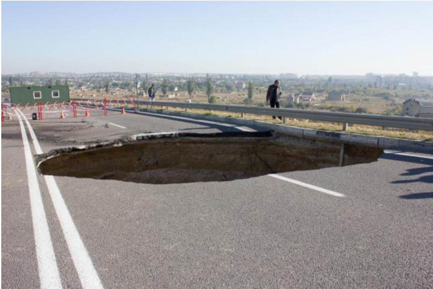
Вид провала с покрытия дороги.
