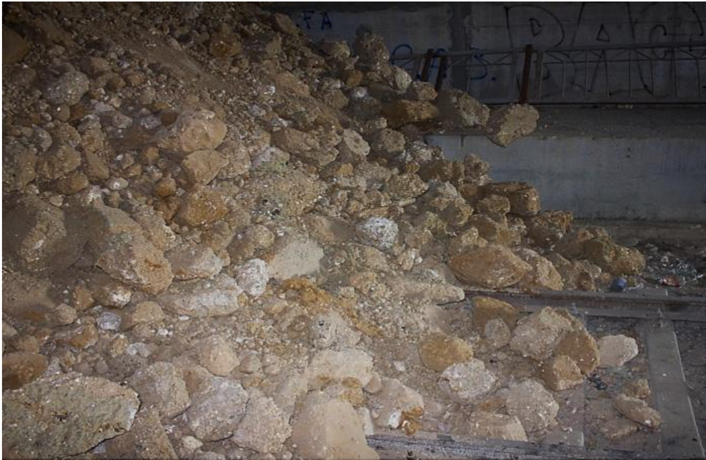
Вид грунта в месте вывала внутрь арки.
