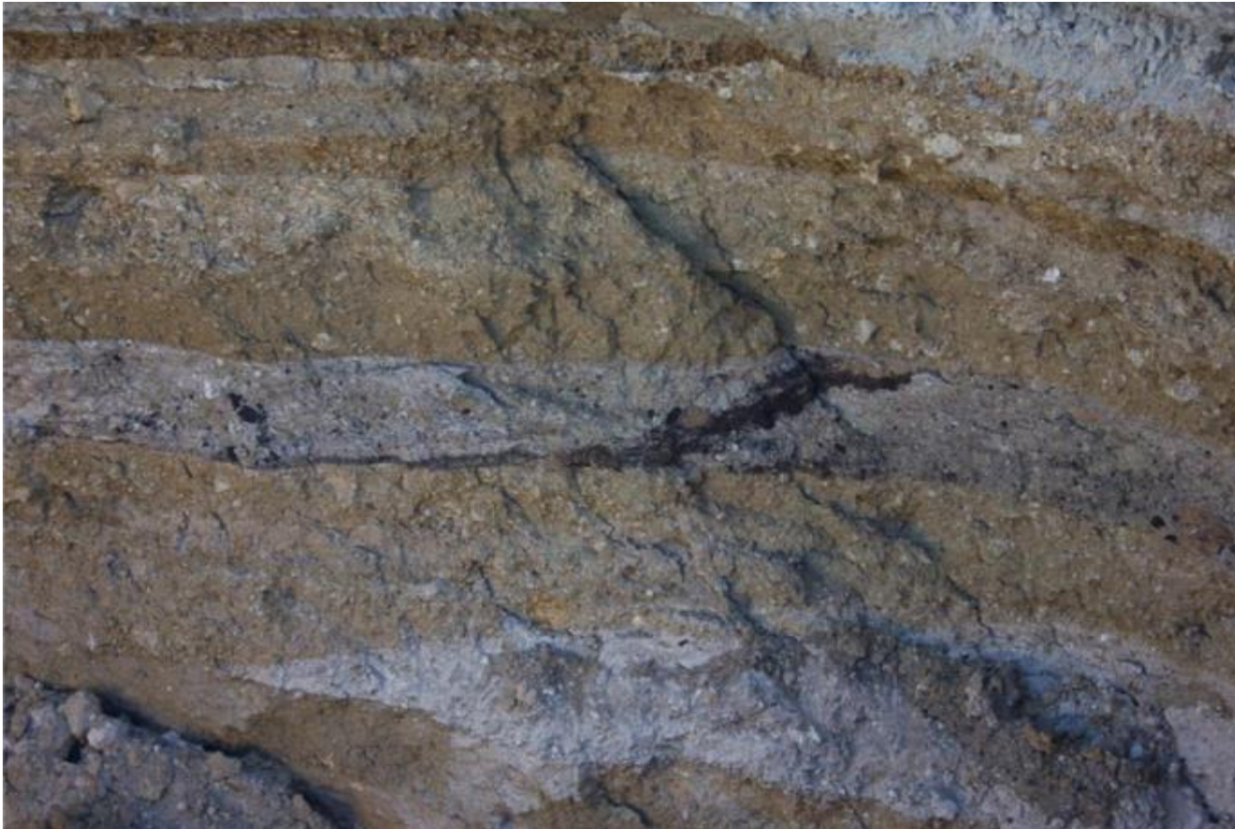
Вид грунта насыпи вертикальной стенки провала.
