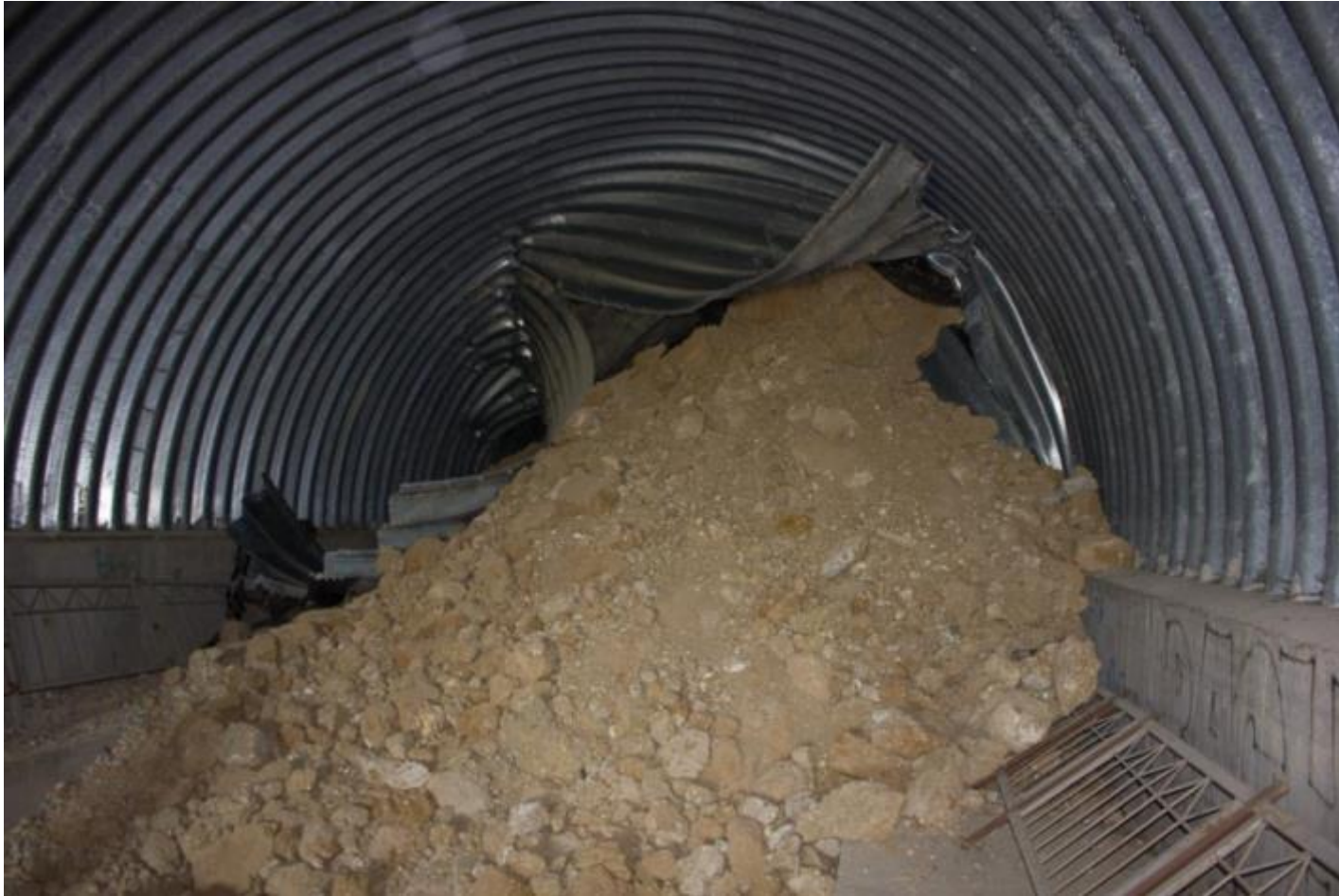
Вывал грунта земляного полотна внутрь арки.
