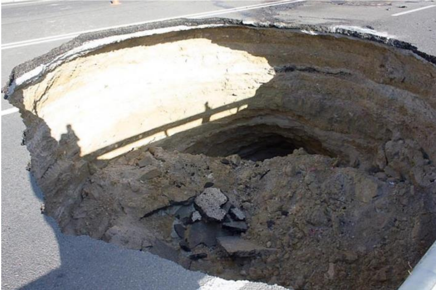
Вид провала с покрытия дороги.
